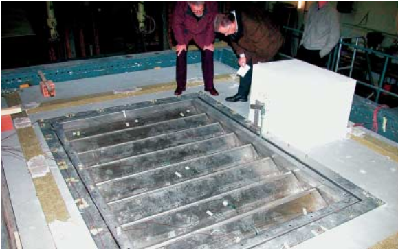
Bild 3: Blick auf die eingebaute, begehbare Klappe. Rechts im Bild das isolierte Gehäuse mit dem Auma-Motor und dem Antrieb auf die Klappe.
